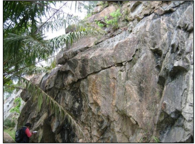
Rajah 1 Risiko bahaya yang boleh disebabkan oleh jatuhan batuan. Keadaan yang sebegini boleh diistilahkan sebagai geobahaya
