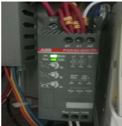
(d) Soft starter for compressor 2
